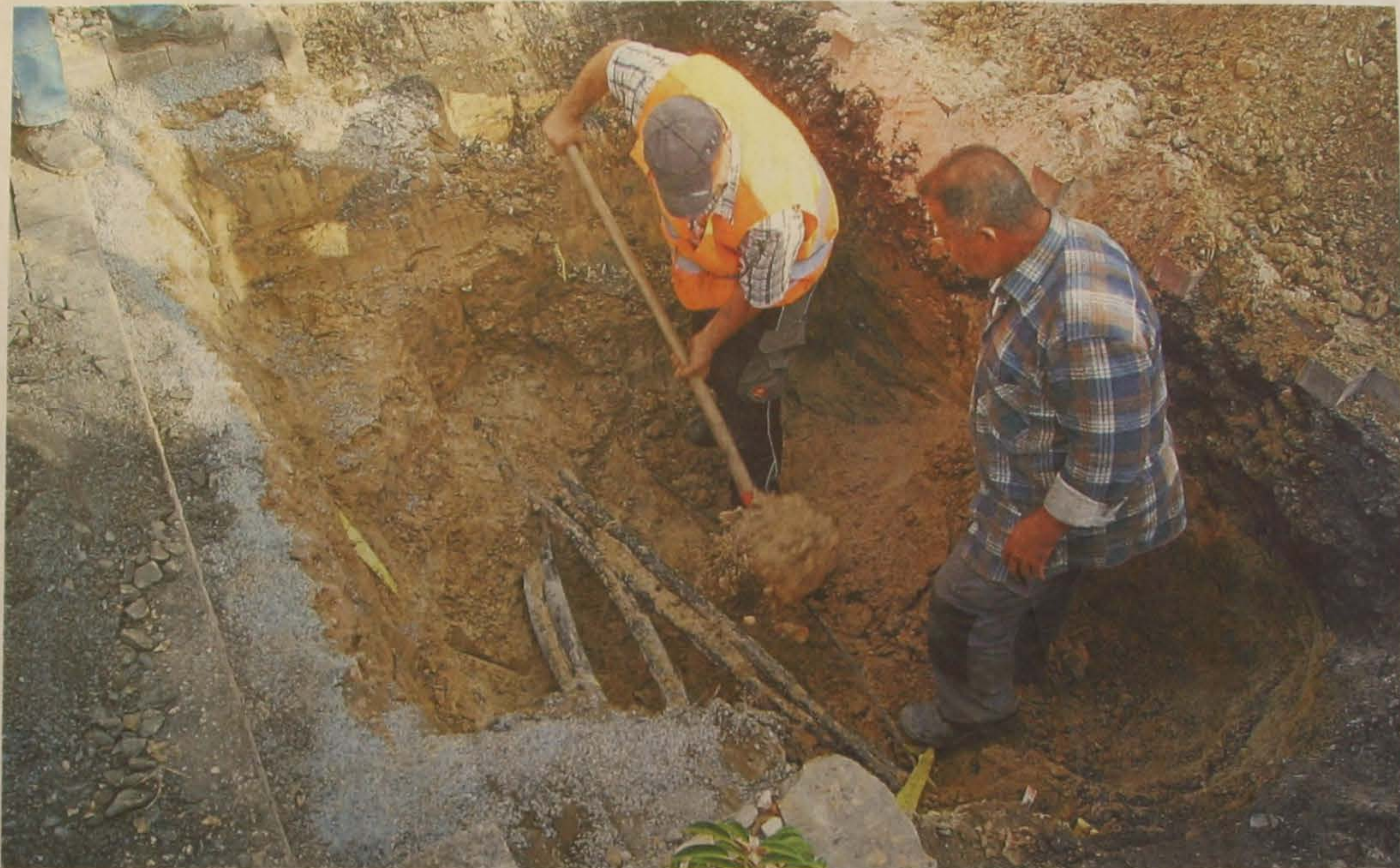
Die Ursache für den Stromausfall in ganz Telgte ist wahrscheinlich dieser Kabelstrang an der Ecke Walter-Gropius-Straße/Max-Beckmann-Weg. Heute soll eine weitere Prüfung erfolgen.
