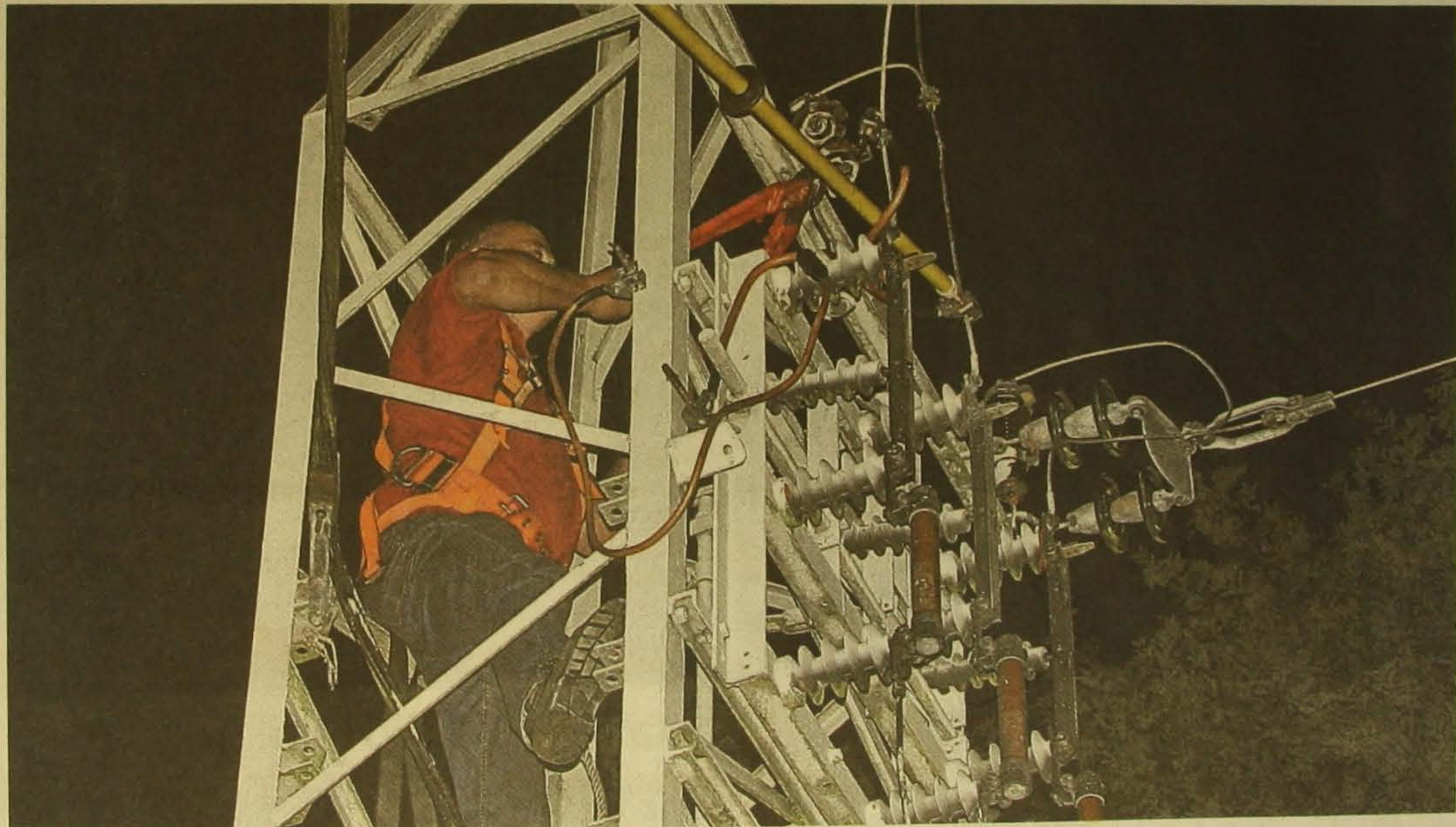
Thomas Wördemann von den Stadtwerken war an der Delsener Heide im Einsatz, wo sich zuvor ein Trafo mit einem lauten Knall verabschiedet hatte.
